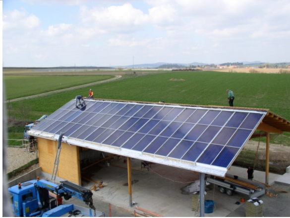
Abb. 2a: Kollektorfeld, Aperturfläche ca. 127 m 2 .
