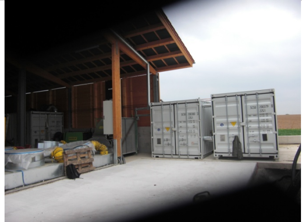
Abb. 2b: Zwei Warmwasserspeicher (Fa. Fsave Solartechnik GmbH) in Übersee-Containern, V_{\text{ges}} ca. 42 m 3 .
