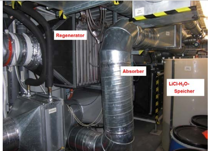
Abb. 9b: Sorptionsanlage (Container-Innenansicht) mit Rohrbündel-Regenerator, Plattenabsorber und Sorbens-Speicher.
